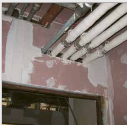
عدم رعایت الزامات کد حریق
