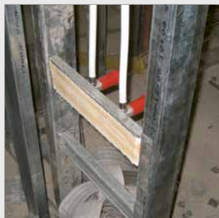
عدم اجرای صحیح جزئیات روشویی
